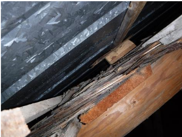
Kuva 27. Nykyisen vesikatteen alla ei ole aluskatetta. Vesikatteen alapuolella on alkuperäinen pärekate.
