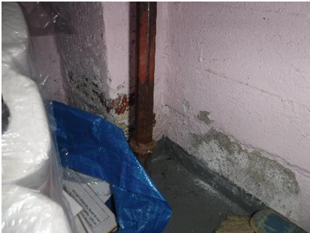
Kuva 11. Maanvastaisien seinien alaosissa on paikoin kosteusvauriojälkiä-
