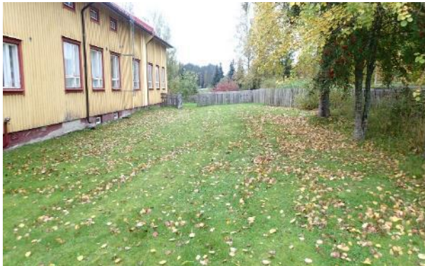
Kuva 1. Rakennuksen kaakkois- ja lounaispuolella maanpinnan kallistukset rakennuksen vierellä olivat liian vähäisiä
