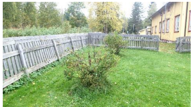
Kuva 4. Piha-aluetta ympäröivä aita on puurakenteinen ja huonossa kunnossa.
