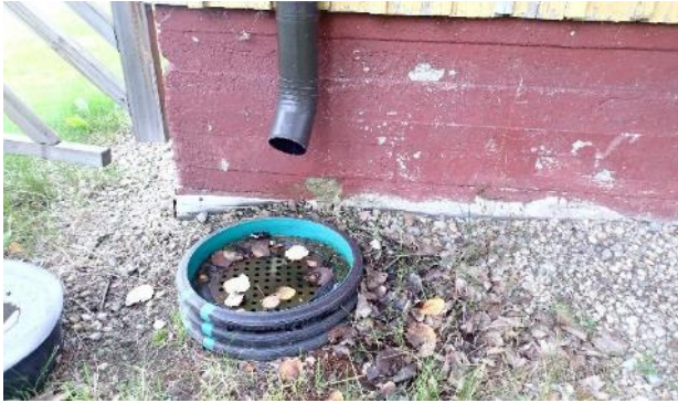
Kuva 9. Sadevedet johdetaan pääosin sadevesikourujen ja syöksytorvien avulla syöksytorvien alla oleviin rännikaivoihin. Rännin pää etäisyys kaivosta on todennäköisesti liian suuri (veden roiskuminen sokkelirakenteeseen on mahdollista).
