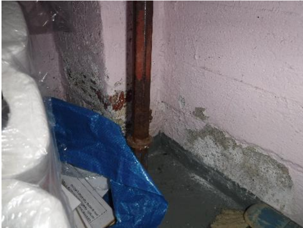
Kuva 21. Kellarin maanpaineseinien ala osissa havaittiin yksittäisissä kosteusvaurioita.
