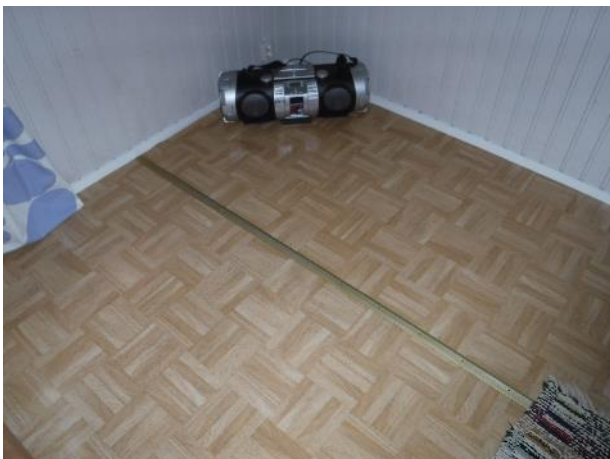
Kuva 23. Tilassa 20 lattiapinnoitteena muovimatto, arviolta 1990-luvulta tai 1980-luvulta. Muovimatto on välttävissä kunnossa. Tekninen käyttöikä päättynyt/päättymässä.
