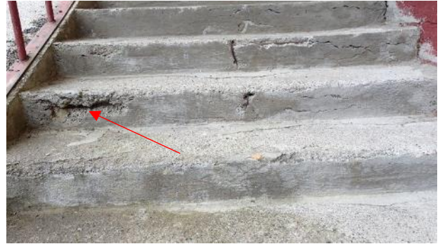
Kuva 6. Portaiden pinnoissa on rapautumaa ja paikoin rungon teräkset ovat näkyvissä
