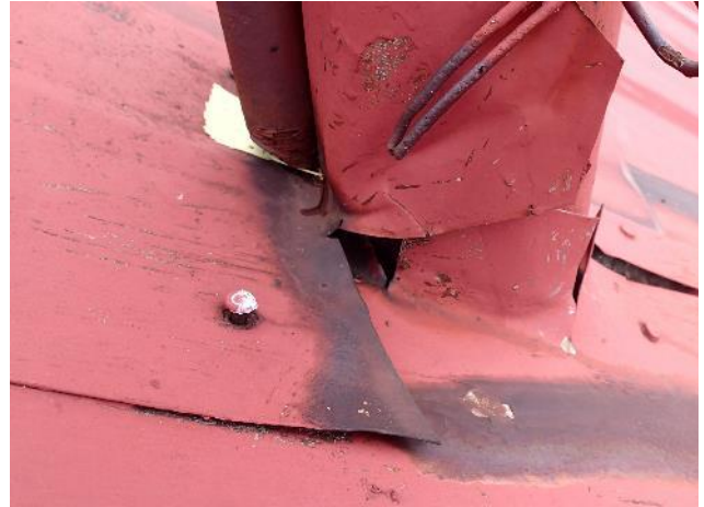
Kuva 31. Vesikatteen läpivienneissä oli silmämääräisesti epätiiveyttä.
