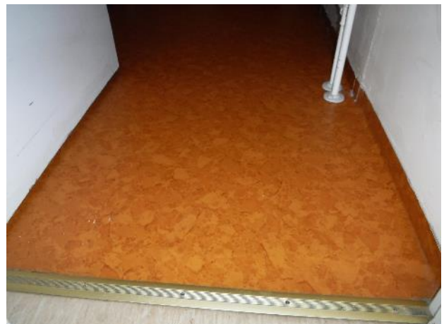
Kuva 24. Tilassa 12 lattiapinnoitteena muovimatto, arviolta 1970 tai vanhempi. Muovimatto on välttävissä kunnossa. Tekninen käyttöikä ylitetty.
