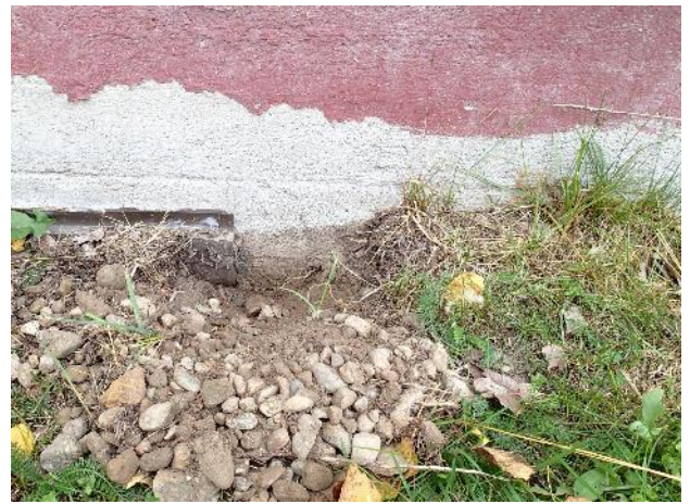
Kuva 16. Sokkelirakenteiden maalipinta oli hilseilyt runsaasti ympärirakennuksen varsinkin lähellä maanpintaa.
