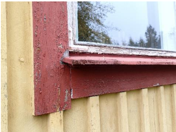
Kuva 15. Ikkunoiden pellitykset olivat huonokuntoiset.
