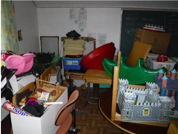
Kuva 25. Tila 205 lattia, seinä ja kattopinnoitteet ovat arviolta 1970-luvulta tai vanhempia. Pinnat ovat välttävissä kunnossa, mutta teknisen käyttöään lopussa. Tilassa paljon tavaraa.
