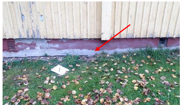
Kuva 8. Tehty perusmuurilevytys ei ole havaintojen perusteella yhtenäinen, vaan se loppuu lounaisseinustalla kellarillisen rakennusosan vaihtuessa vapaasti tuuletettuun alapohjarakenteeseen. Sokkelin maalipinnat ovat huonokuntoiset.
