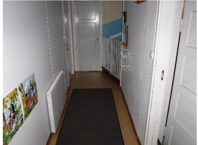
Kuva 18. Rakennuksen tilanjako-osat (väliseinät) olivat pääosin lastulevypintaisia ja maalattuja, pinnat olivat välttävässä kunnossa.
