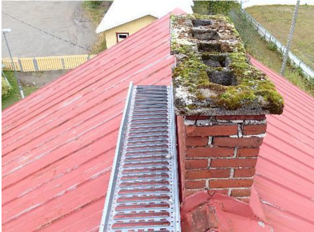
Kuva 30. Rakennuksen piippujen päällä ei ollut hattuja ja piipun yläosat olivat pahoin rapautuneet.
