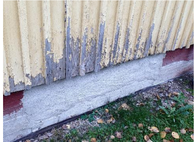
Kuva 14. Julkisivun maalipinnat olivat huonossa kunnossa. Paikoin maalipinta hilseilyt kokonaan pois. Lisäksi paikoin havaittiin pystylaudoituksen alaosissa kuivaa lahoa.
