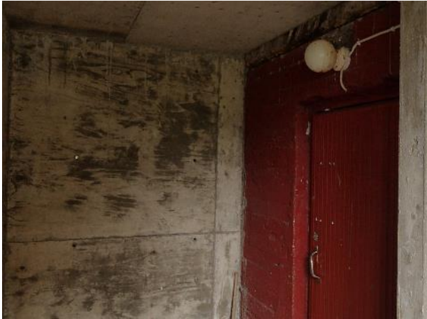
Kuva 17. Kellarin ulko-ovi on alkuperäinen ja elinkaarensa lopussa.
