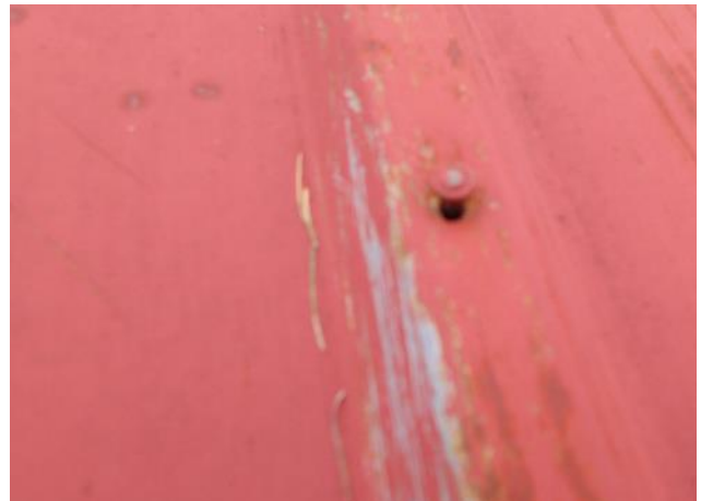
Kuva 28. Vesikatteen kiinnitysnaulat olivat paikoin nousseet ylös.
