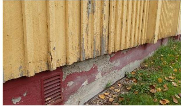
Kuva 10. Sokkelin pinnoissa havaittiin halkeamia, jotka voivat viitata rakenteissa tapahtumiin muodonmuutoksiin
